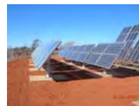
Wirrappa Solar Array
